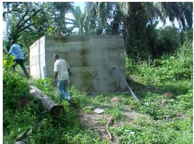
Eine Leitung führt das Wasser aus dem Wasserspeicher zur Verteilerstelle.
